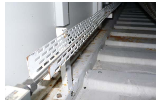
Emcara PRD สำหรับป้องกันอัคคีภัย ติดตั้งอยู่ภายในตู้คอนเทนเนอร์
