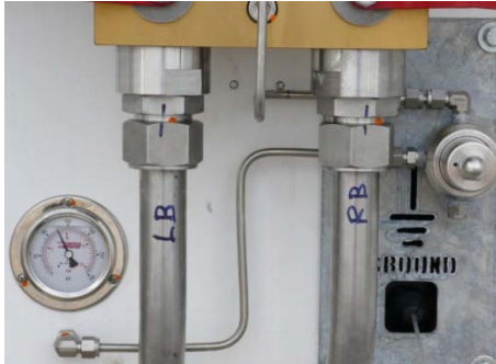
วาล์วควบคุมแรงดันพร้อมเกจวัดแรงดัน สำหรับควบคุมอุปกรณ์ป้องกันอัคคีภัย
